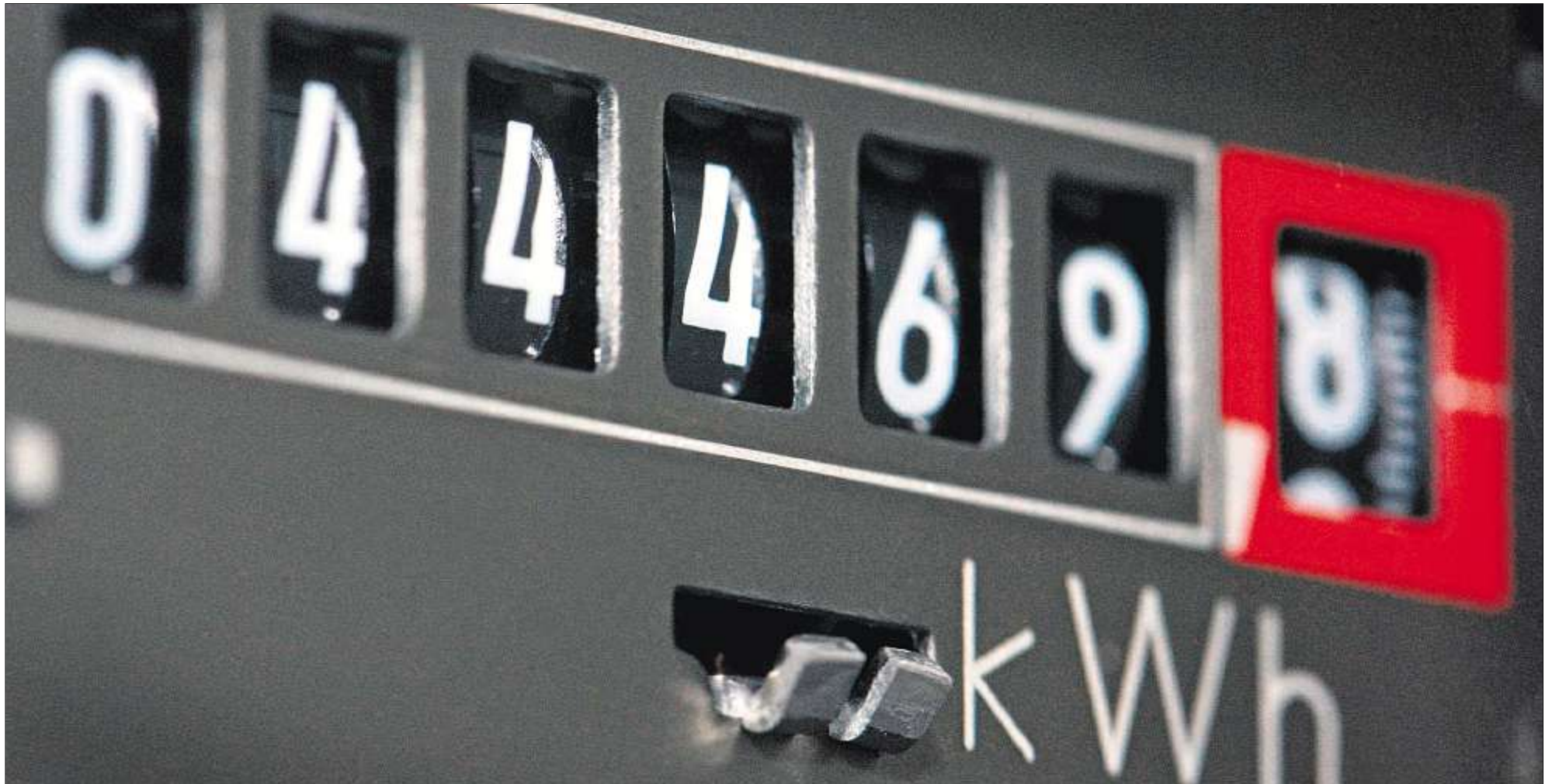
Millionen alte Stromzähler in Deutschland haben bald ausgedient. Die neuen Smart-Meter können dann auch die Energiewende-Idee der dezentralen Versorgung perfekt unterstützen. Fotos: R. M.
